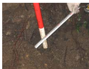
写真-2 接合樹部パイピング跡
