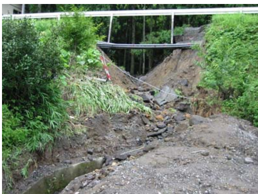
写真-1 県道北里宮原線被災状況(下流側→上流側)
